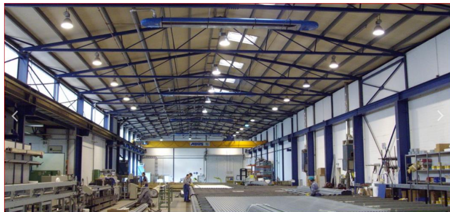
Infrarot-Dunkelstrahler der Serie OPTIMA plus sorgen für die Energie sparende Beheizung einer Produktionshalle. (Quelle: KÜBLER)
