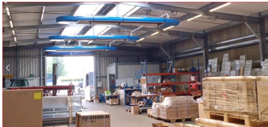
Intelligente Software-Module wie TorOff sorgen dafür, den Energieverlust durch offene Hallentore zu vermeiden. (Quelle: KÜBLER)
